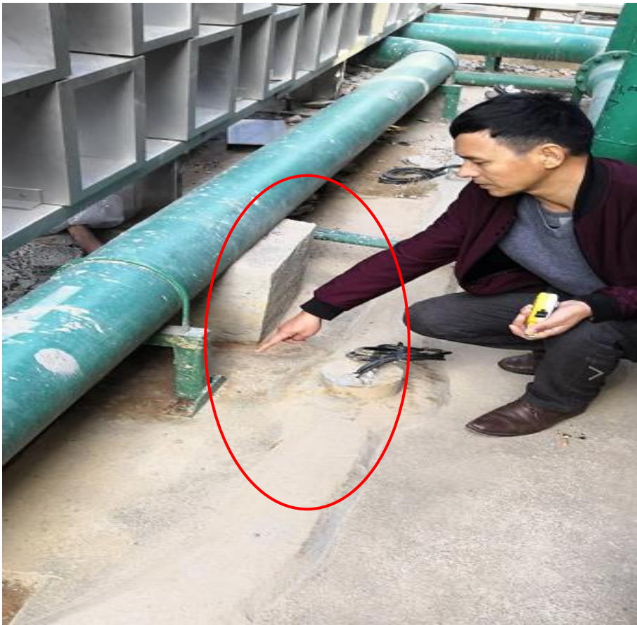
冉红斌在脚手架上高坠后的坠落位置
