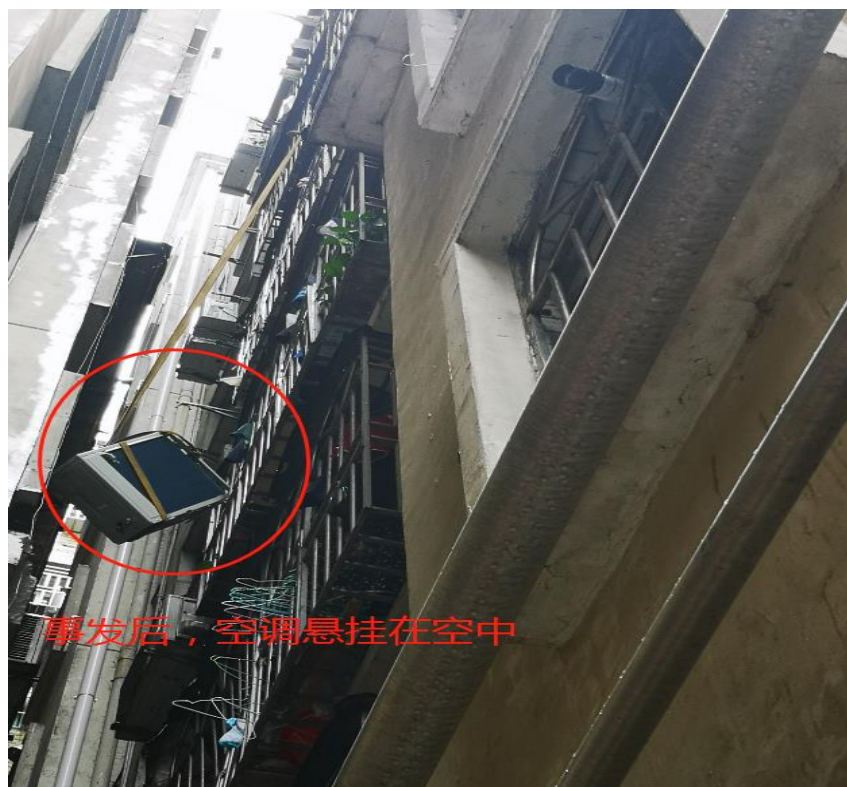
(图五) 事发后，空调悬挂在空中。
